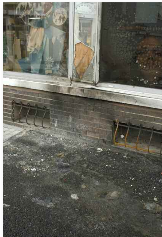
CC Les dégâts causés à une partie de la vitrine de la pharmacie de la place Jaurès-Breton.
