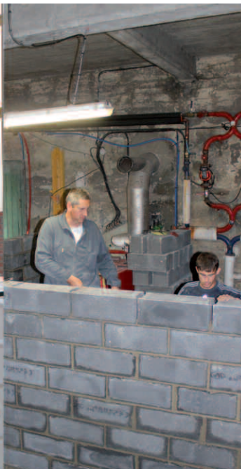
travaux à la salle Delory, reprise des enduits intérieurs à l'école Morieux et maçonnerie dans la chaufferie à l'école Buisson
